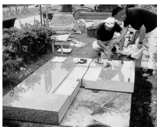
▲基礎工事のコンクリートの場面上に台石を載せている場面
